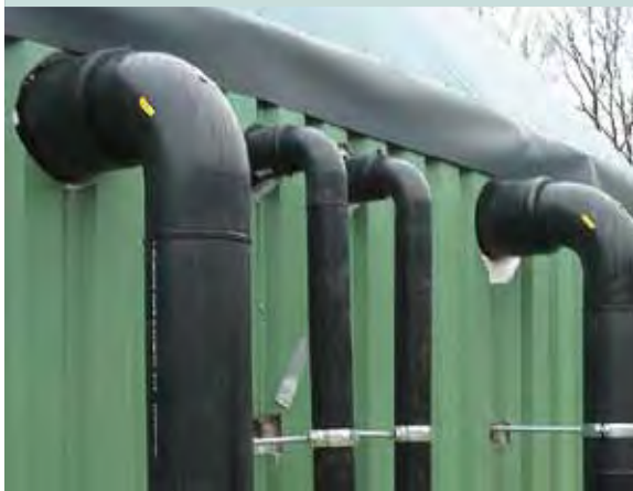
Abb. 3 – Rohrleitungen aus PE-el für die Biogasanwendung
